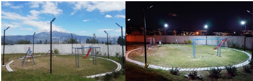
Figura 3 – Implementación del sistema fotovoltaico
